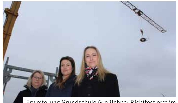
Erweiterung Grundschule Großlehna: Richtfest erst im März, feierliche Einweihung bereits im Dezember
